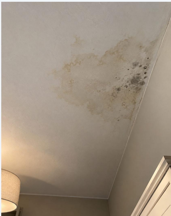
Deutliche Feuchtigkeit / Schimmel
